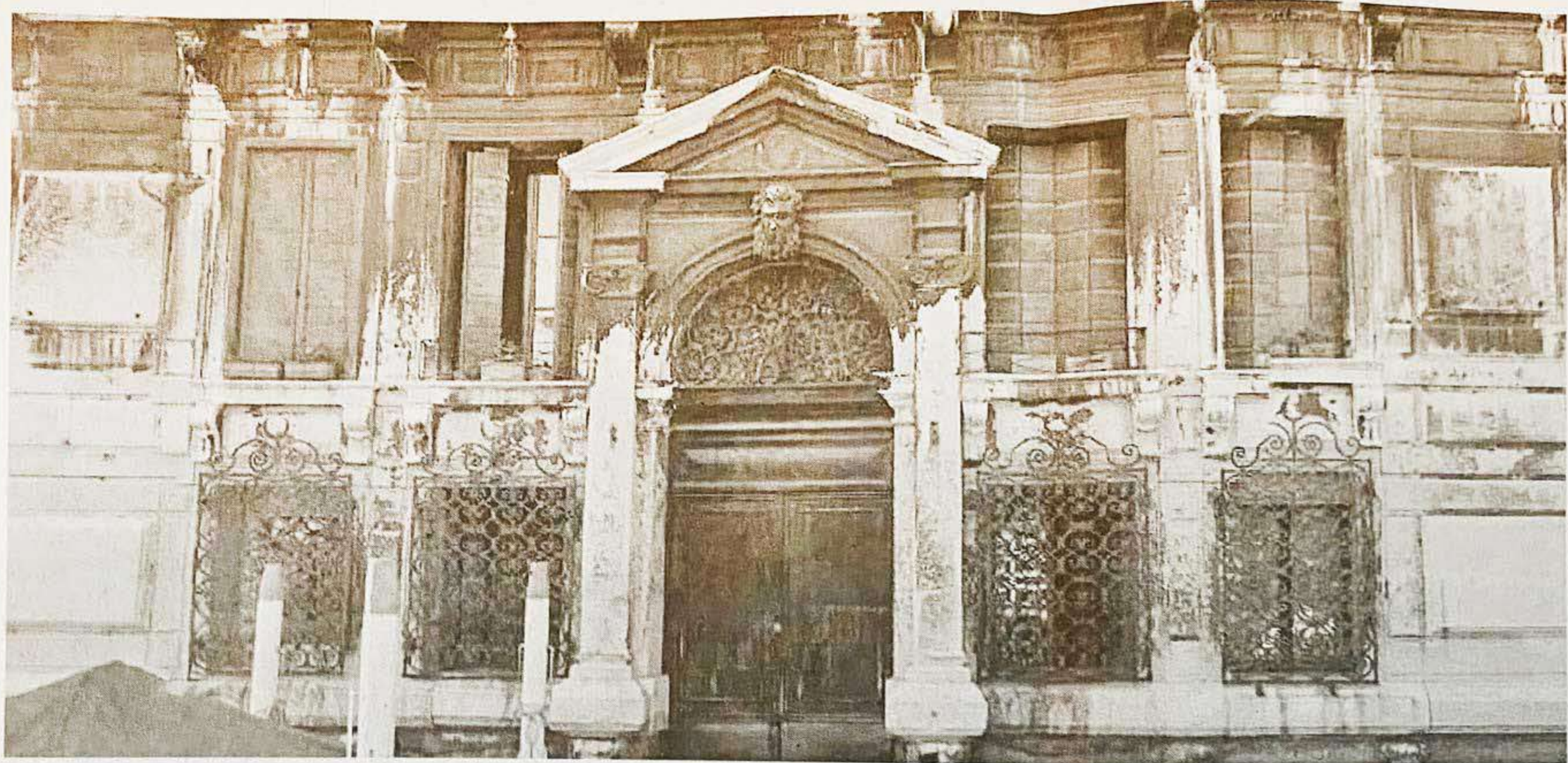
Der gegenwärtige Zustand der Fassade.
