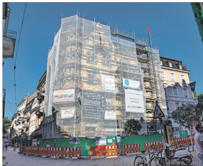
Das bei einem Brand schwer beschädigte Gebäude am Sonnenplatz feiert im Rahmen der Sanierung bald Richtfest.
